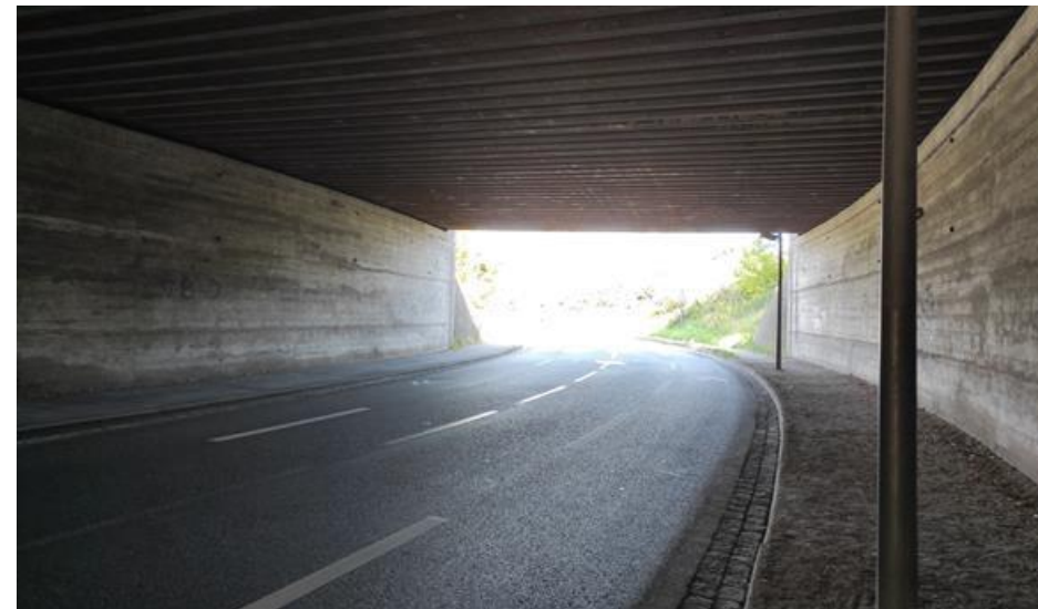
Visibilité restreinte sous le franchissement des voies ferrées
